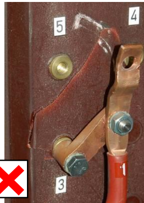
Fig. 12: Não permitido! Fragmentação da superfície por golpe violento na ligação do circuito
